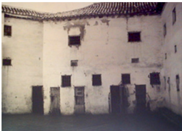
Figura 75: Estado de deterioro que presentaba el patio de los Inocentes, cuando el edificio fue vendido a la Universidad. ADPG.
